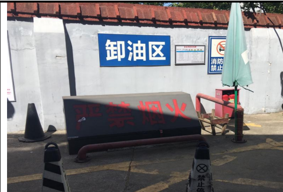
卸油区油气回收装置
