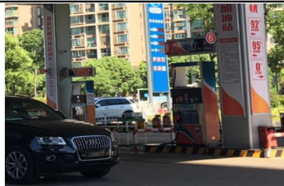
加油区油气回收装置
