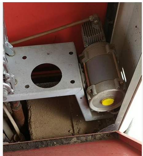
油气回收设施
