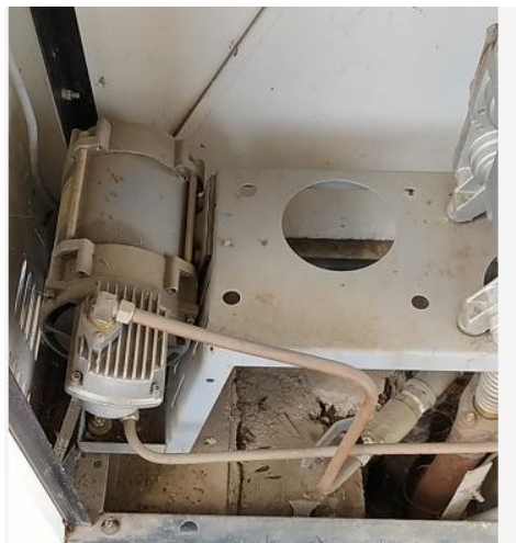
油气回收设施
