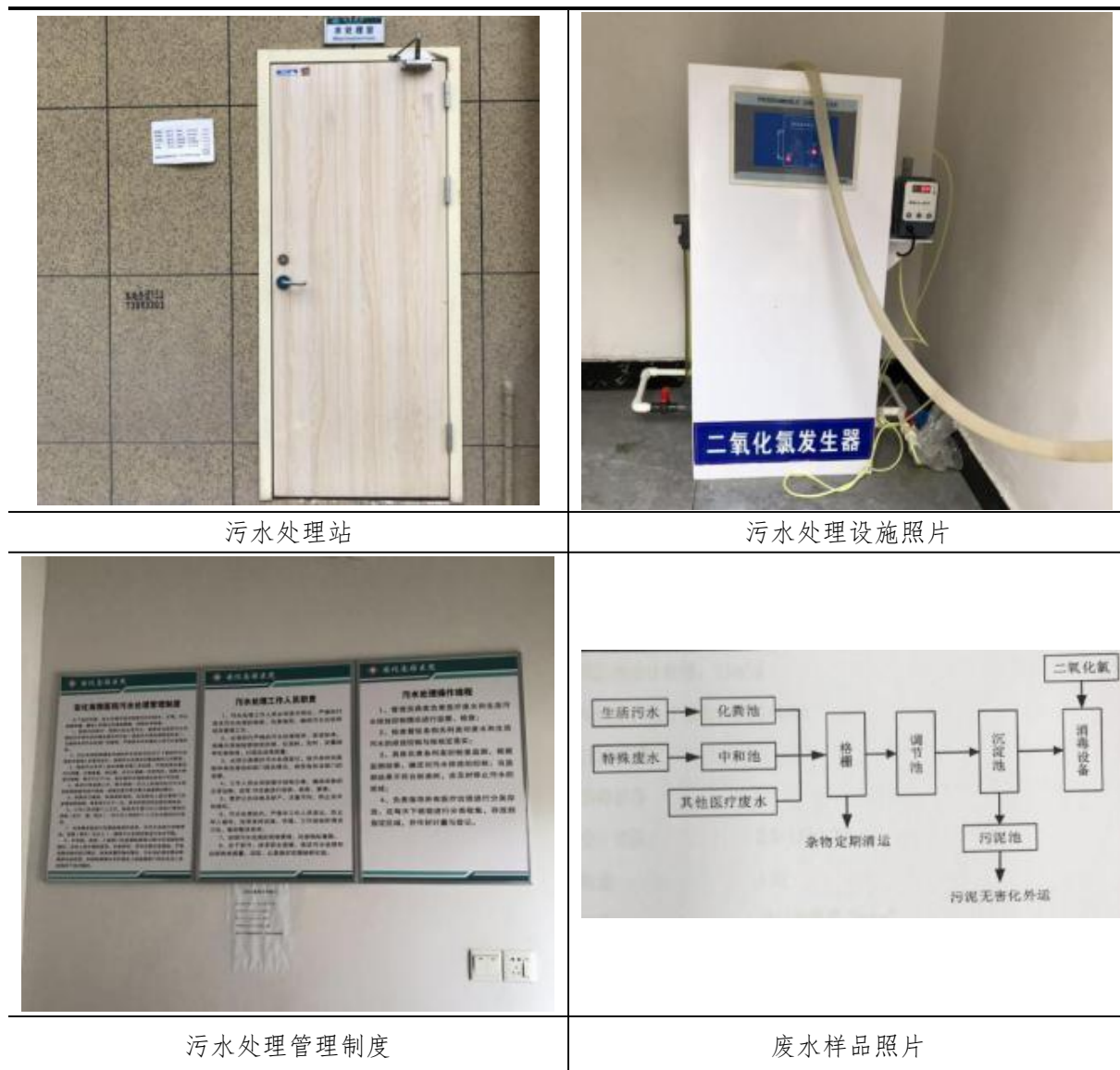
图 4-1 废水处理设施照片
