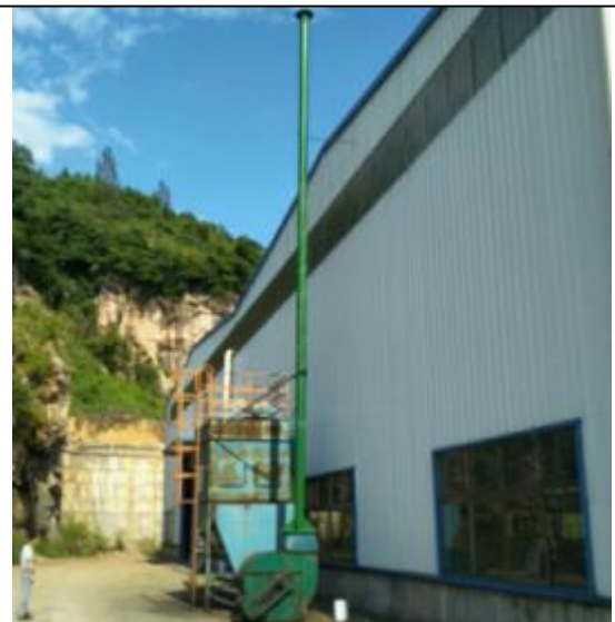
布袋除尘设施
