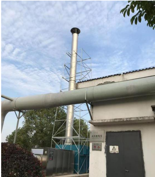
离子除臭设施
