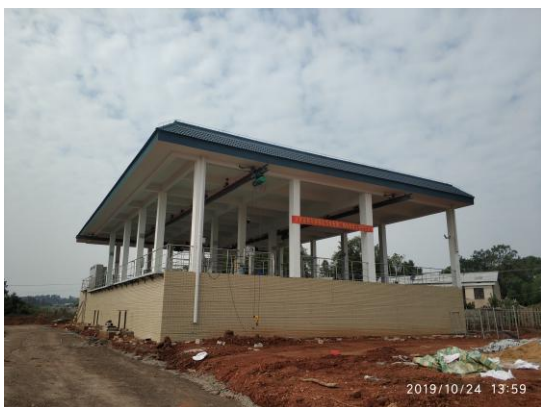
中间泵房及高效沉淀池（本期工程）
